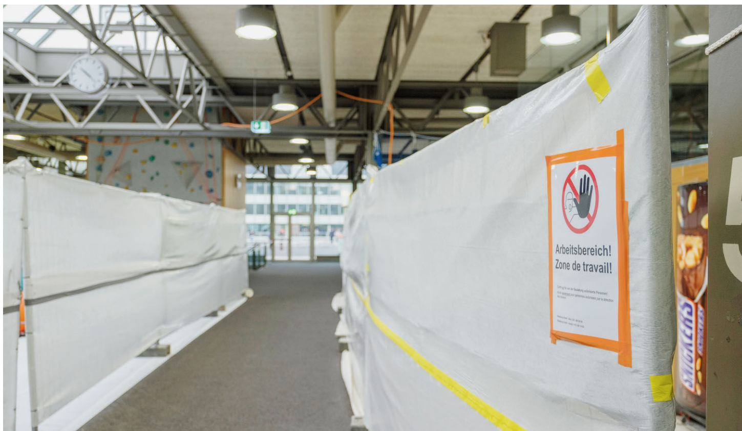
Les salles de gym ont été endommagées par un dégât des eaux en été. Il était prévu qu'elles rouvrent en octobre, voire à la fin de l'année. Mais l'étendue des dégâts s'est avérée plus importante que prévu. AIMÉ EHI
